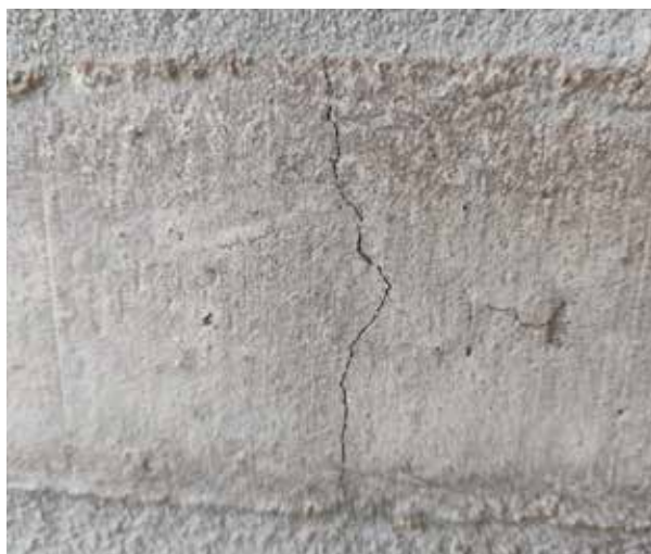
Eksempel på kølerevne / stenrevner
