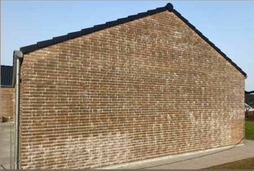
Svært misfarvet murværk forårsaget af massiv vandpåvirkning
